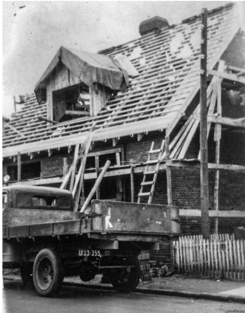
Det røde hus ved siden af butikken er ved at blive bygget i efteråret 1954. Det er færdigt før nytår, hvorefter Anton og Cecilie flytter ind.
